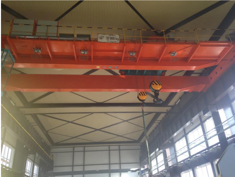
Obr. č.1 Mostový žeriav 32/8t v montážnej hale
